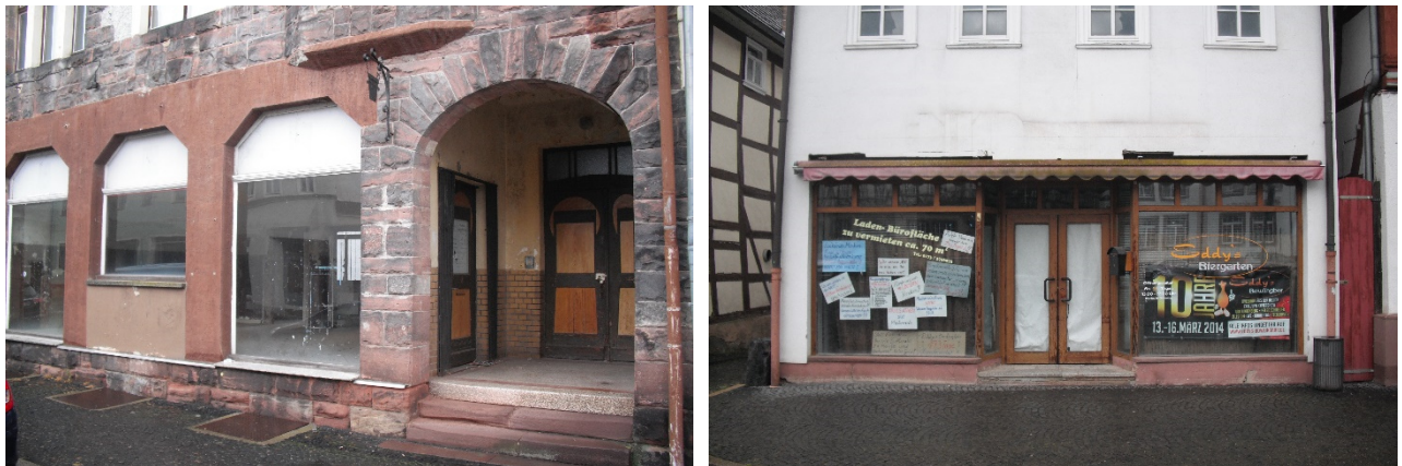
Abbildung 19: Innerstädtische Leerstandsflächen – sanierungsbedürftig (Auswahl)
